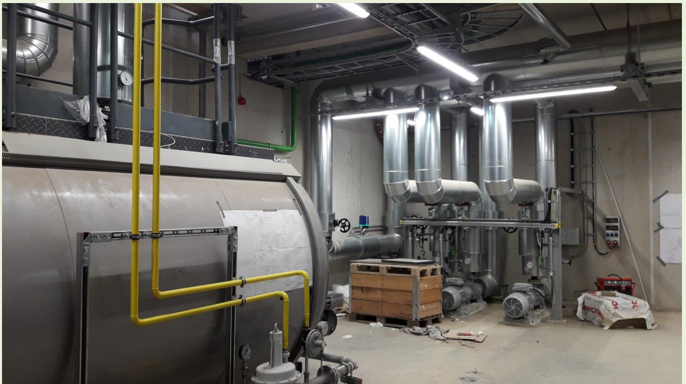
Gaskessel (links) und zentrale Pumpenstation des Fernwärmenetzes
